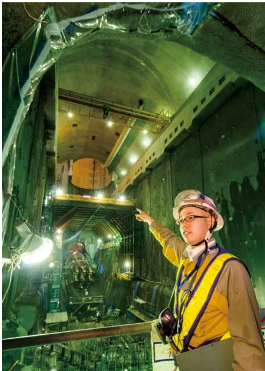
竹畑が設計に携わった1号機主機室。ダム近くの地下に高さ約40メートルの巨大な空間が広がる。
