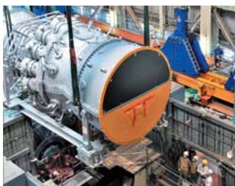
知多第二火力発電所にて取り替えを行った最新型のガスタービン。
