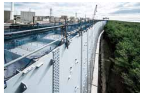
海拔22メートルへのかさ上げ工事で強化を図る浜岡原子力発電所の防波壁。
