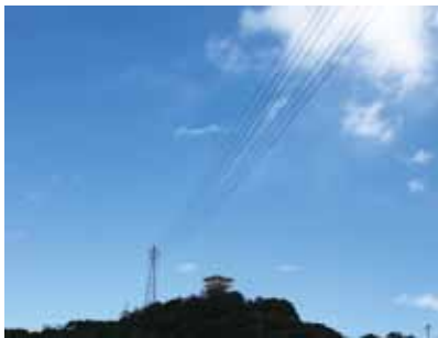
離島の架空電線
