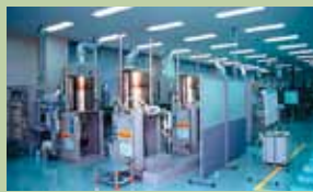
配管劣化、熱疲労などの高経年化研究施設
