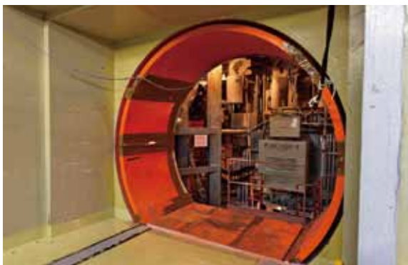
解体を待つ浜岡1号機の原子炉格納容器の出入口。運転中は厚さ2mのコンクリートプラグで蓋をして放射線を遮蔽する。格納容器内にある原子炉を含め全ての機器を解体する予定。
