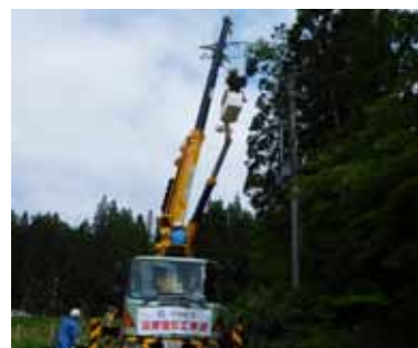
停電の原因を倒木と想定。倒木箇所を発見した後、北陸電工（北陸電力の関係会社）によって復旧工事が行われる。
