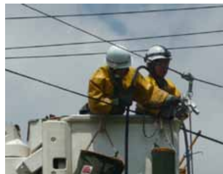
鉄塔が傾斜した停電エリアは復旧時間を要するため、高圧発電機車を配電線につなげて応急送電を実施。九州電力の指揮の下、他電力と協力し復旧に努めた。
