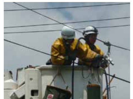
鉄塔が傾斜した停電エリアは復旧時間を要するため、高圧発電機車を配電線につなげて応急送電を実施。九州電力の指揮の下、他電力と協力し復旧に努めた。
