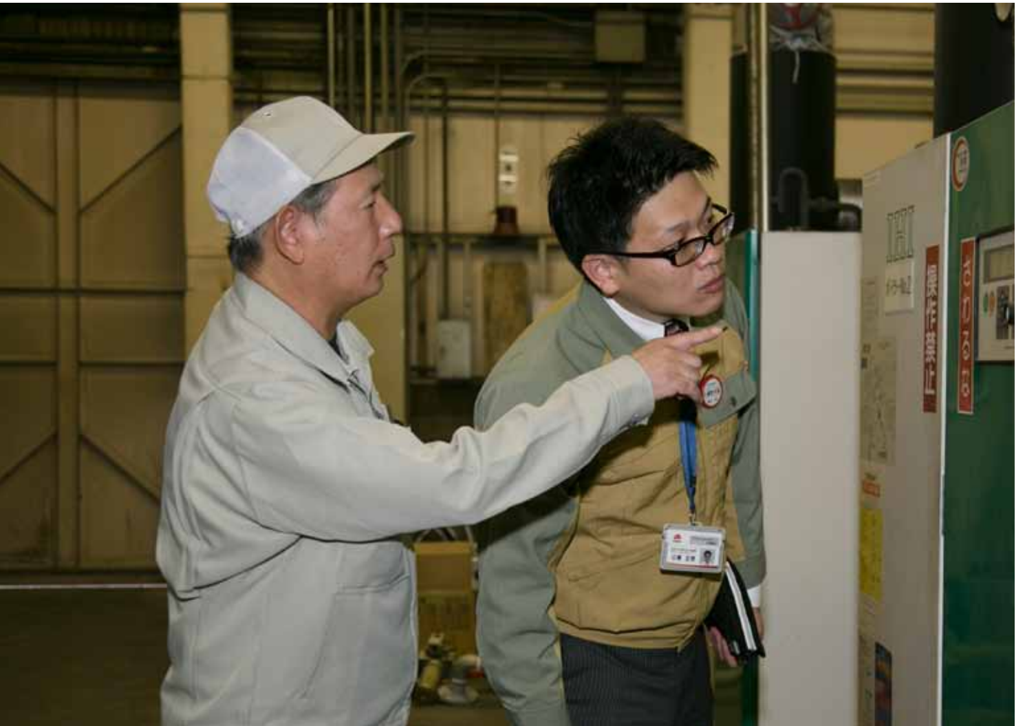
ボイラーは、工場の熱源として重要な設備だけに運転状態の確認が欠かせない(左はお取引先企業の工務課長様)。
